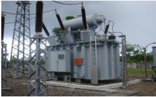
Gambar 2.1. Transformator daya yang terpasang pada GI Titi Kuning
