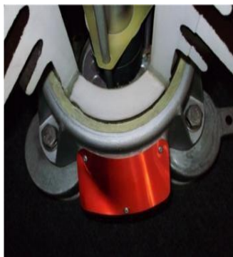
Gambar 2.9 Insulator dudukan arrester
