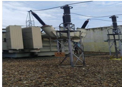
Gambar 3.4. Name plate dan posisi Lightning Arrester yang terpasang
