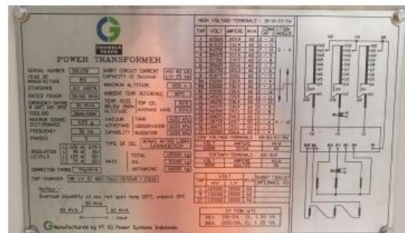
Gambar 3.5 Transformator Daya dan nameplate Transformator
